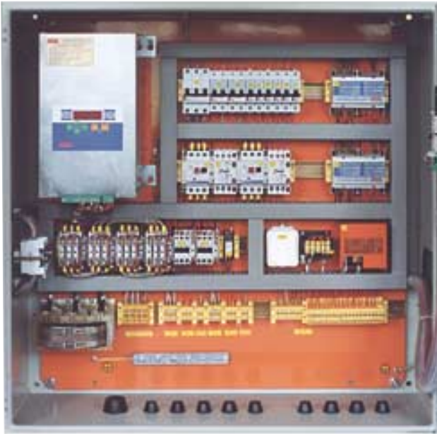
Wnętrze szafy sterowniczej dwóch dmuchaw o mocy 15kW
