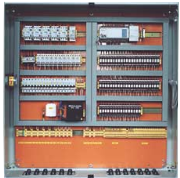
Układ sterowania procesem odwapniania wody z ujęcia głębinowego. Wnętrze szafy sterowniczej. Układ oparty na sterowniku Mitsubishi.
